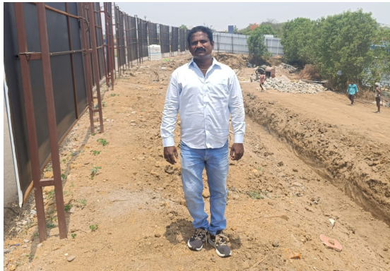
చేశారు. వెంటనే వాటిని తొలగించాలని నిర్మాణ సంస్థకు, ఇరిగేషన్ అధికారులు హెచ్చరించారు. పూడ్చివేతలు చేపట్టిన చోట మళ్లీ నిర్మాణం కోసం పనులు ప్రారంభిస్తే చర్యలు తప్పవు కేసులు నమోదు చేస్తామని ఇరిగేషన్ ఏఈ నరేందర్ హెచ్చరించారు.
